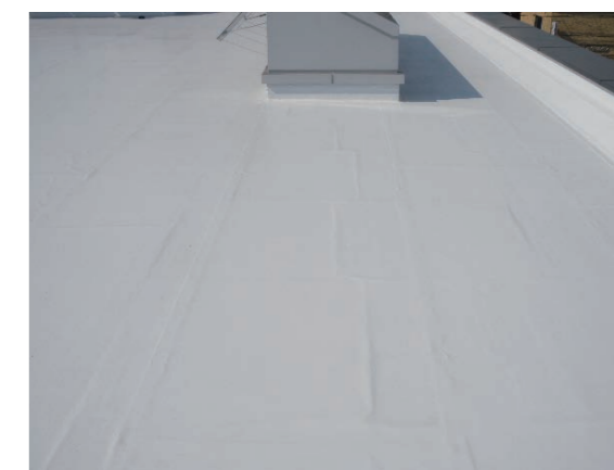
断熱材の段差
