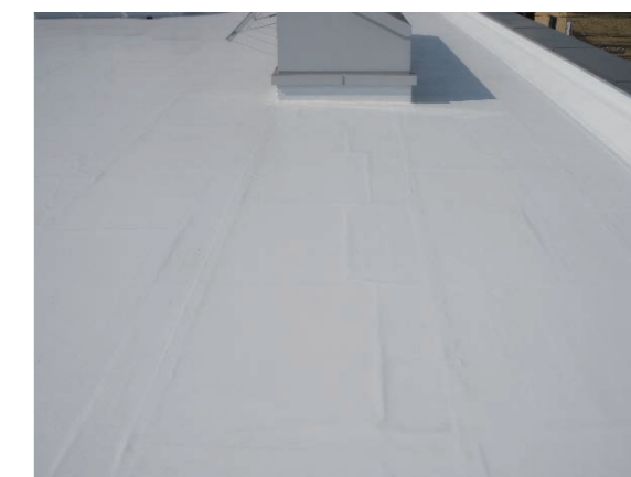
断熱材の段差
