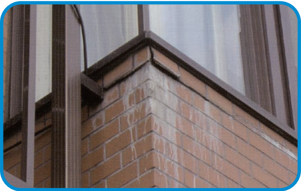
サッシ廻りタイルの浮き
