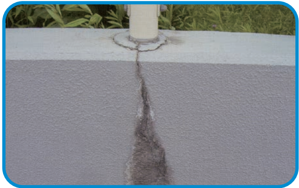
手摺り部分のひび割れ
