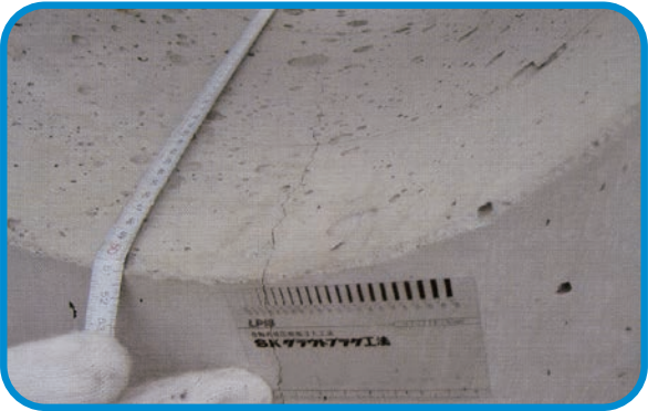
コンクリート構造物のひび割れ
