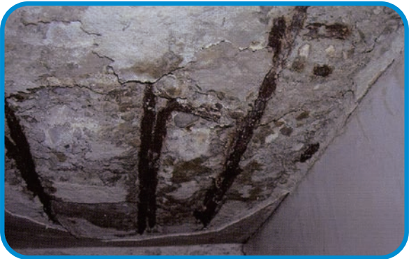
コンクリートの露筋、欠損
