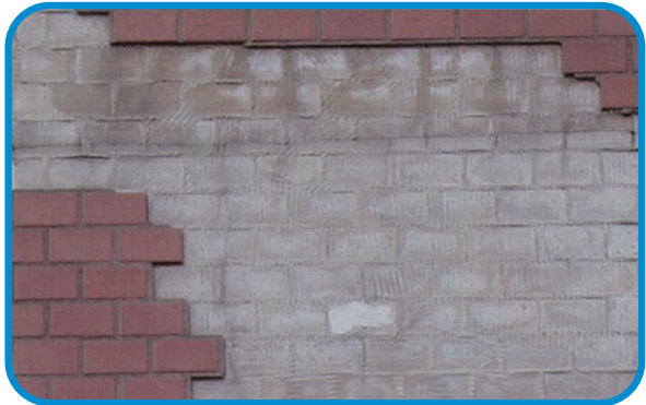
タイル張り外壁の浮き
