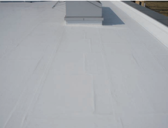
断熱材の段差
