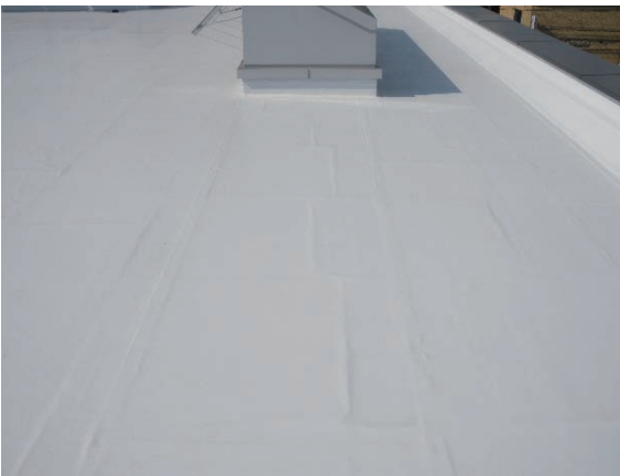
断熱材の段差
