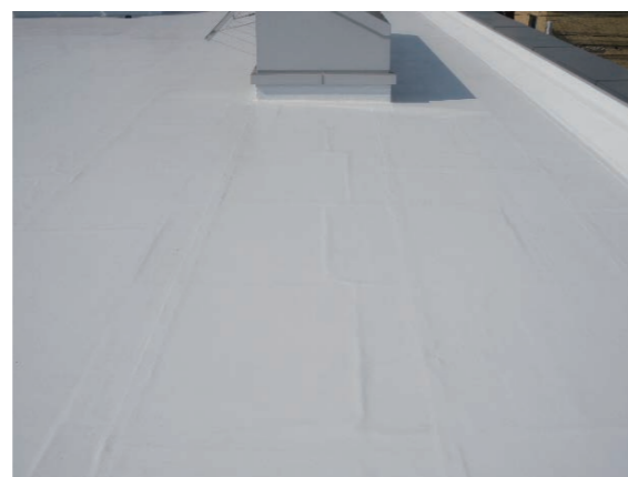
断熱材の段差
