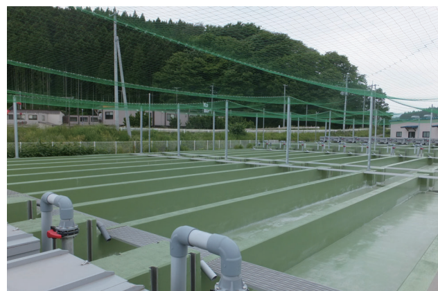
漁業施設(養魚場)
