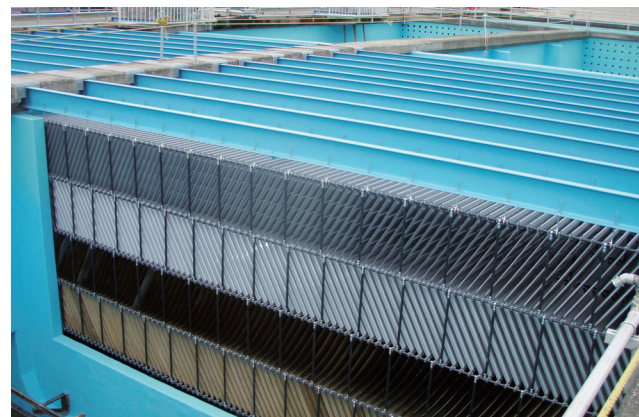
上水施設(着水井、沈殿池)
