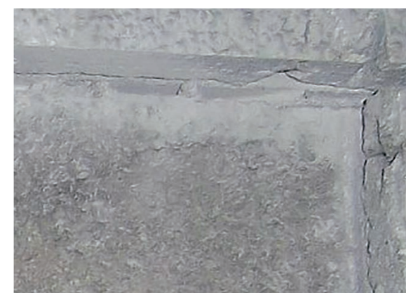
躯体コンクリートとモルタル間の浮き
