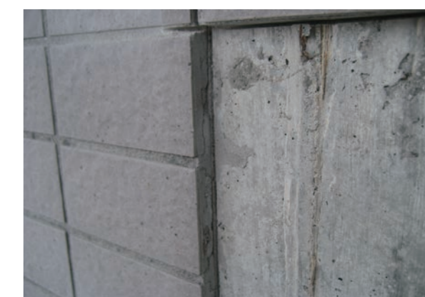
躯体コンクリートと張付けモルタル間の浮き(直張り)
