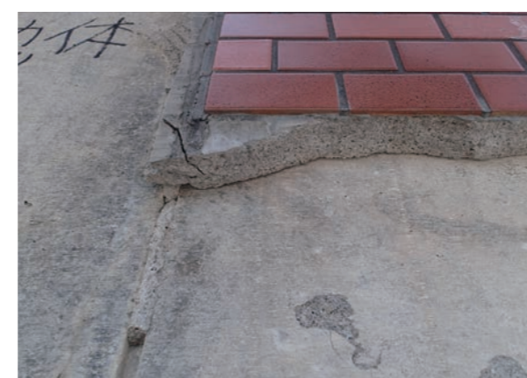
躯体コンクリートと下地モルタル間の浮き
