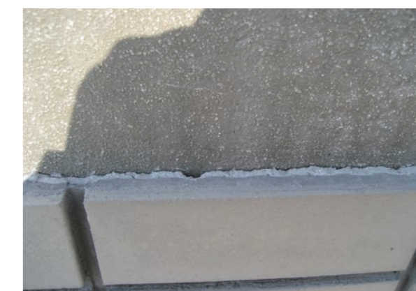
下地モルタルと張付けモルタル間の浮き
