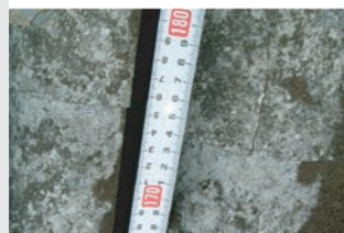
風圧や建物挙動により、周囲がひび割れ雨水が浸入
