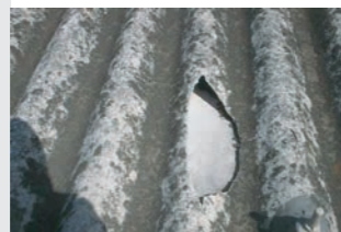
ひょうや設置物の転倒により、屋根が破損して雨水が浸入。
