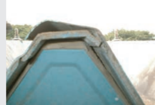
重ね部分が口開きし、風混じり雨の際、雨水が浸入。
