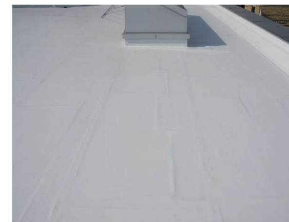
断熱材の段差
