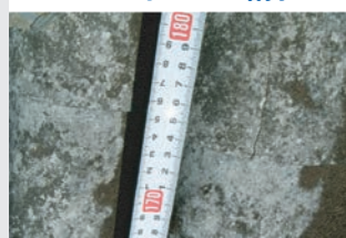
風圧や建物挙動により、周囲がひび割れ雨水が浸入
