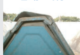
重ね部分が口開きし、風混じり雨の際、雨水が浸入。
