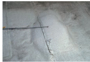
露出アスファルト防水 (平場防水層の著しい膨れ)
