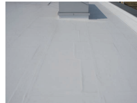
断熱材の段差
