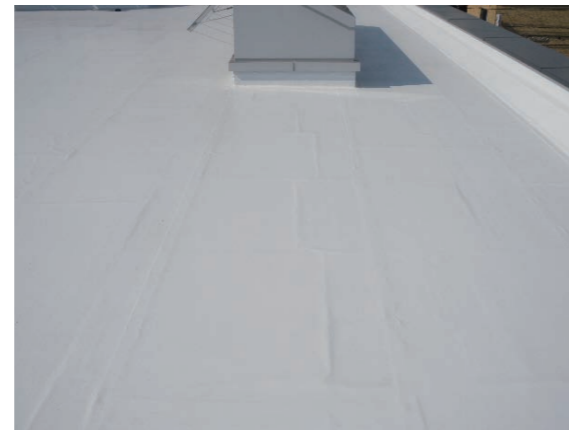
断熱材の段差
