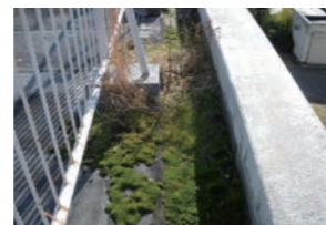
露出アスファルト防水 (植物の繁茂・コケの発生)
