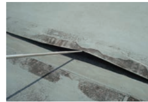
シート防水 (シートジョイントの破断)
