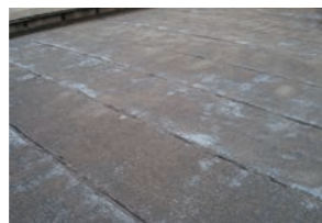
露出アスファルト防水 (トップコートの消失)
