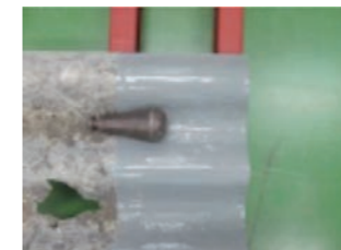
①スレート下地(無処理)の試験後 貫通孔が発生
