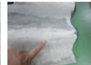
②FS-S2仕様の試験後 表面は異常なし、裏面のスレート板に亀裂発生
