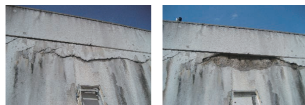
露筋欠損等で構造物の耐力低下につながる可能性がある。
