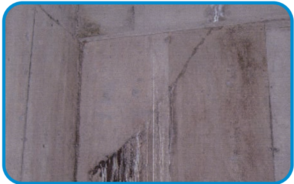
ひび割れからの漏水
