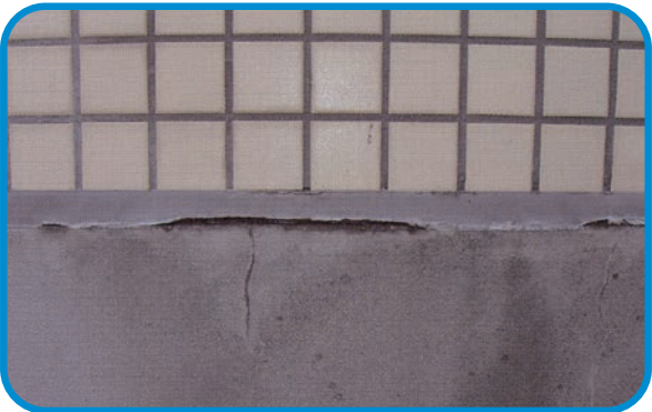
シーリング材の劣化・剥離
