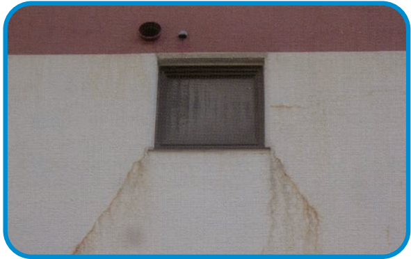
外壁のひび割れ
