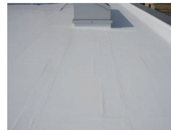
断熱材の段差
