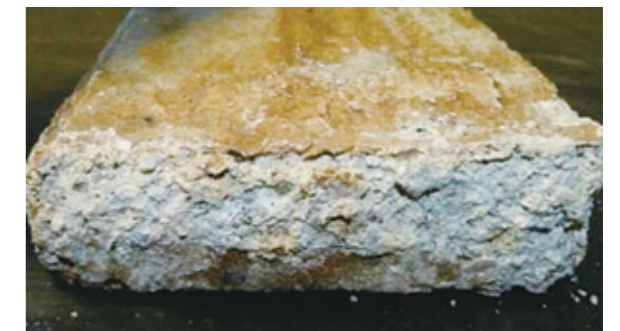
比較用試験体 (防食層未塗布)
